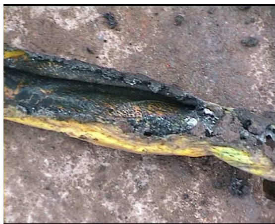
PE 110 potrubí plynu, zničené taveninou
