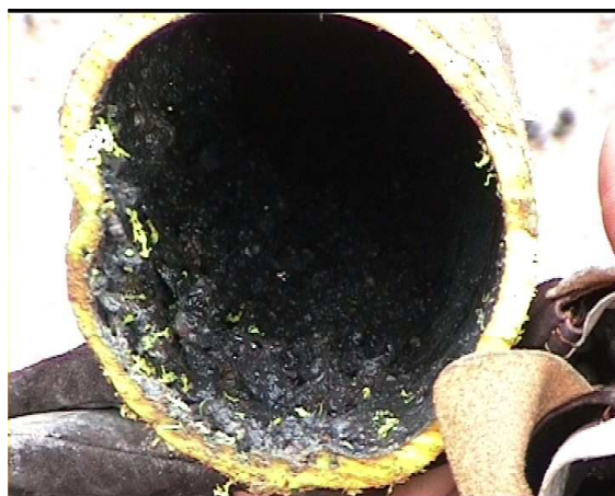
PE 110 s taveninou Si, Cu, Al, Pb, která potrubím volně protékala. Tavenina je ze zkratu el. kabelů umístěných nad plynovodem
