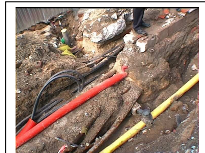
nehodná chránička vede plyn rovnou do domu (již vybuchl)
